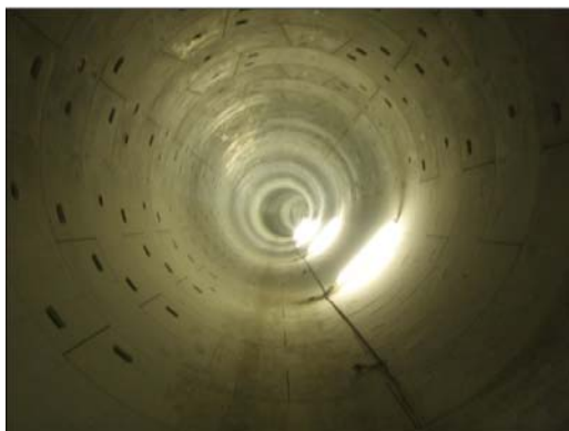
滝川分水路:管路分(管径 \phi 3600)
