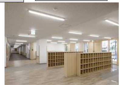
【鵠南小学校に導入した LED 照明】
