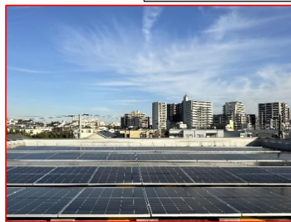
【藤沢市立本町小学校に増設した 太陽光発電システム (85 kW)】
