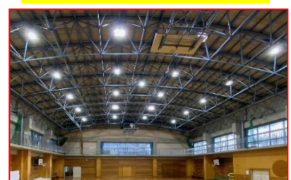
【石川小学校体育館の LED 照明】
