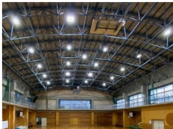
【石川小学校体育館のLED照明】
