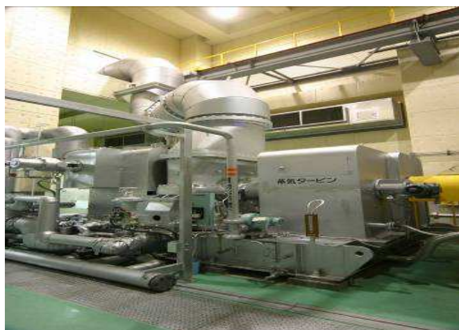
【蒸気タービン&発電機】
