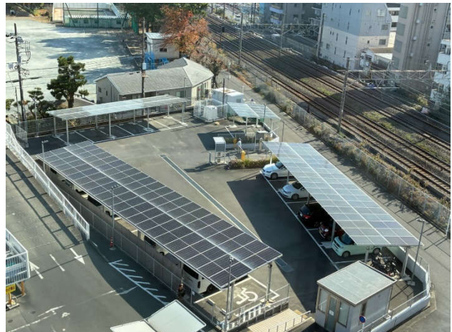
市役所朝日町駐車場（ソーラーカーポート）
