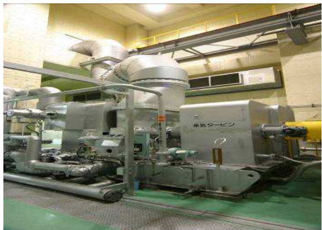
【蒸気タービン&発電機】
