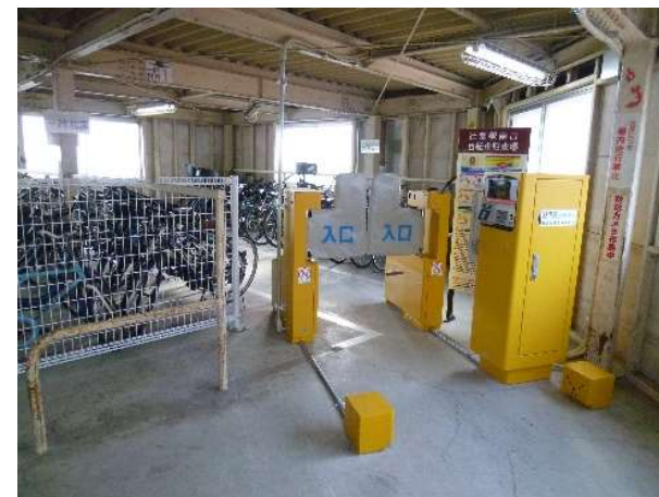
出入口部の機械化 (辻堂駅南口自転車駐車場)
