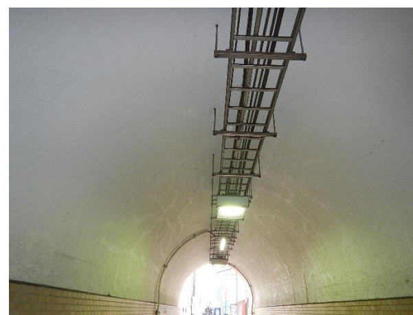
トンネルアーチ部の照明施設(村岡人道トンネル)
