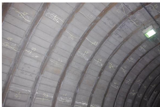
ひび割れ状況(村岡トンネル)
