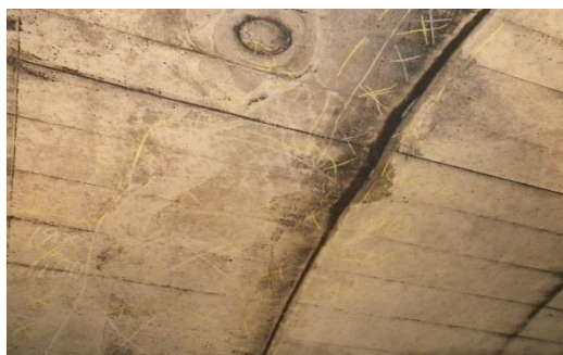
浮き状況(大庭トンネル)
