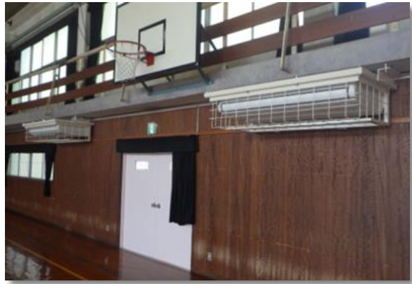
屋内運動場に整備した空調設備
