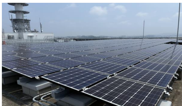
太陽光発電システム
