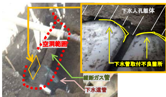
図3 開削範囲内の管路輻輳状況と空洞発生原因箇所
