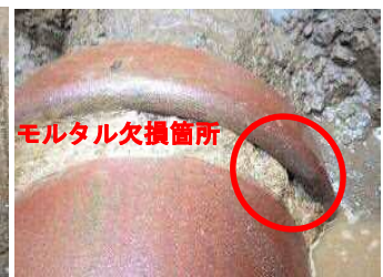
図-11. 継手欠損箇所
