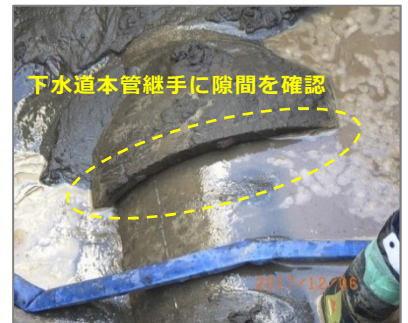
図-4 空洞原因事例：下水道本管継手部のわずかな隙間
