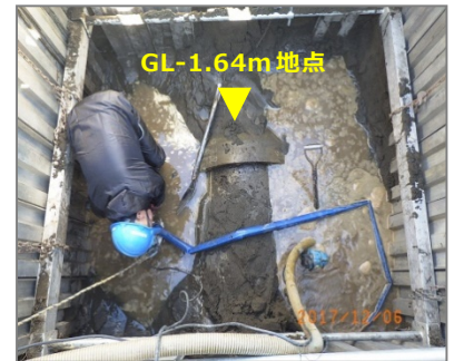
図-3 空洞原因調査状況
