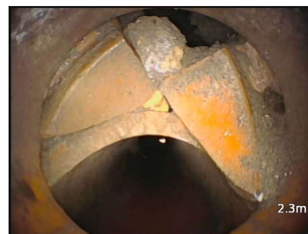
取付け管 異常
