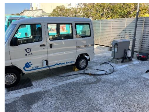
V2H充放電設備
