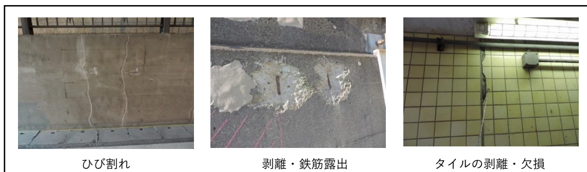
図 2-1. 主な変状状況
