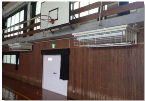
屋内運動場に整備した空調設備
