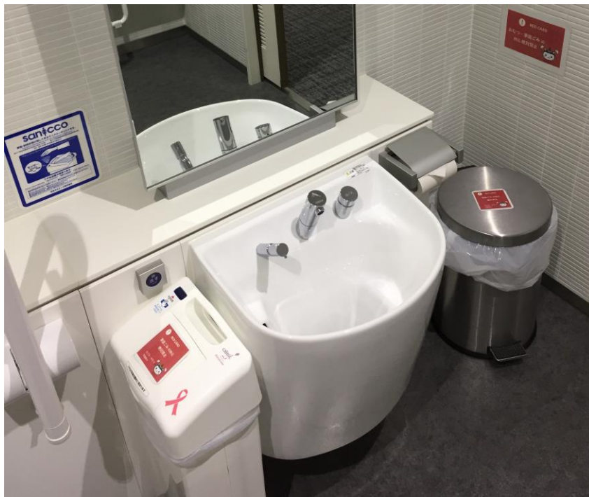
本庁舎1階の「多目的トイレ」に設置されているオストメイト対応設備
