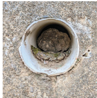
土砂の詰まり
