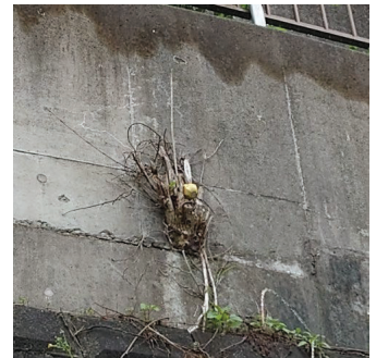
水抜き穴から植物
