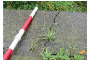
開いた亀裂（頭部）
