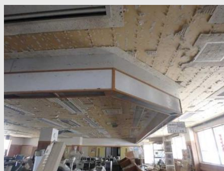
図 水没後に落下したロックウール吸音天井板
