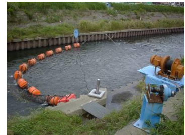
境川除じん機(大清水橋上流)
