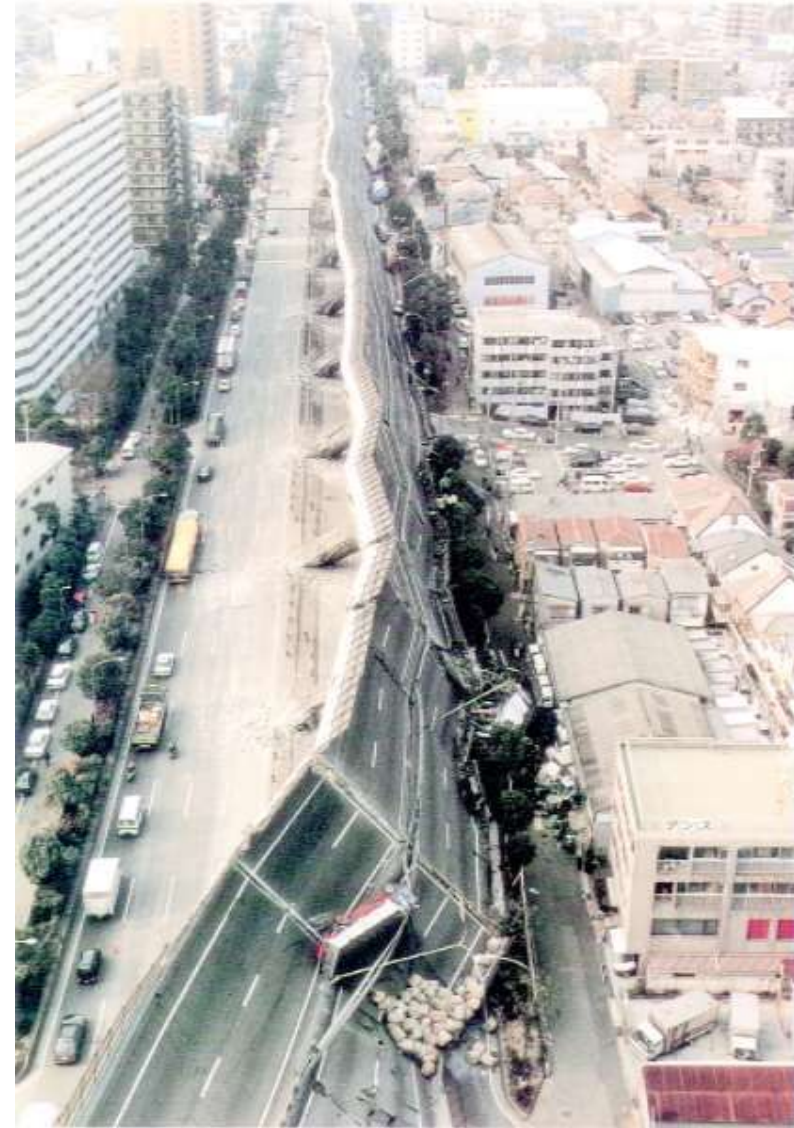
単柱コンクリート高架橋の崩壊 5学会
